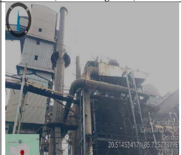
DRI P.H. (Stack & Baghouse)
